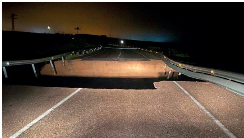
Figura 3: Hundimiento en la carretera de Valmojado a Casarrubios del Monte
