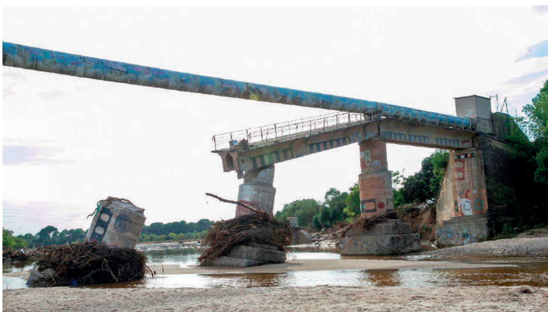
Figura 1: Tubería de Picadas
