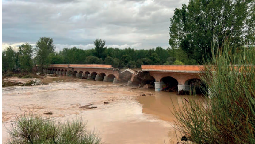
Figura 2: Puente destruido en Aldea del Fresno
